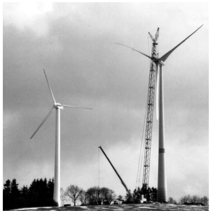
Der Rotor der E-82 ist montiert. Im Vordergrund eine 600 kW Vestas Anlage aus 1996
